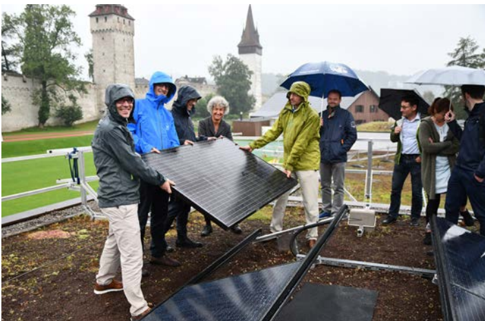
Einweihung der Photovoltaik-Anlage
